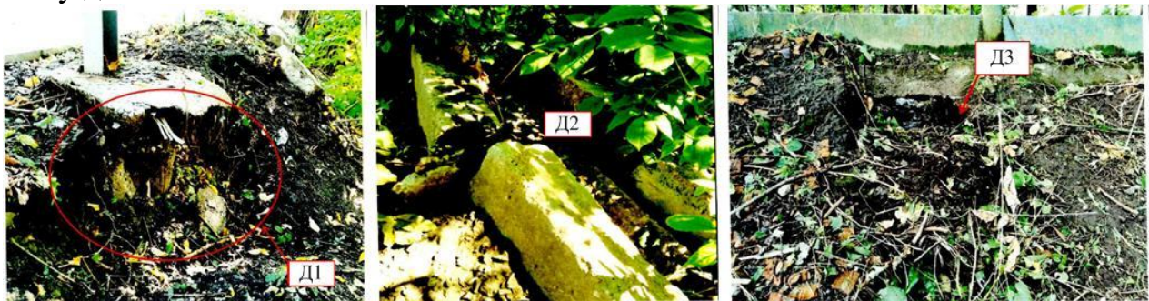
Рис. 1. Результати візуального обстеження водопропускної дамби
